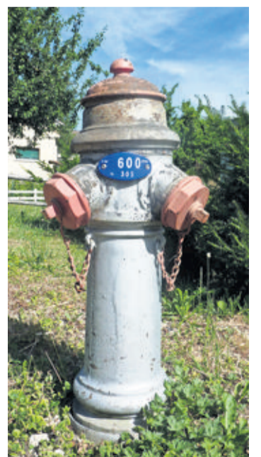
Toutes les bornes hydrantes, ici l'une d'elles de Champtauroz, ont été inventoriées et contrôlées.
